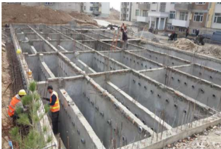
شکل 2: نمایی از تصفیه خانه غیر متمرکز در یکی از شهرک های شهر کابل (9)
